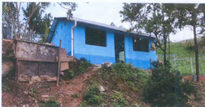
Foto 1: Vista lateral de los canales de agua pluvial instalados.
